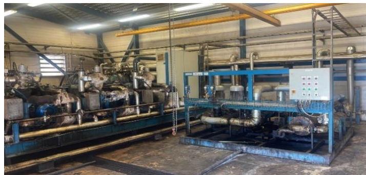
صورة (2) ضاغط الهواء
